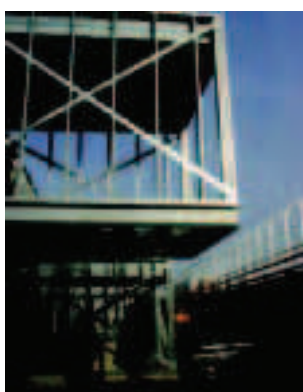
Ossature légère avec un porte-à-faux nécessitant une reprise sur profils standards. Cité Manifeste à Mulhouse D. Lewis, Scape architecture+Block.
