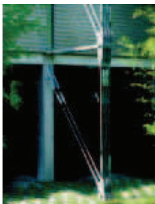
Un jeu de tirants obliques et de bielles assure le contreventement transversal rejeté à l'extérieur. Immeuble d'habitation à Constance, Allemagne. Ingo Bucher-Beholz architecte.
