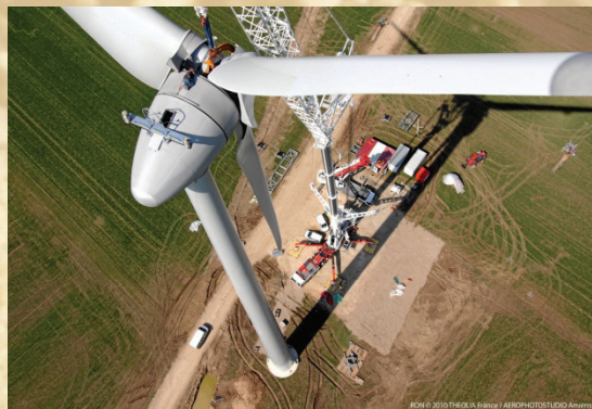
▲ Vue aérienne de l'éolienne de Fressenneville finie
