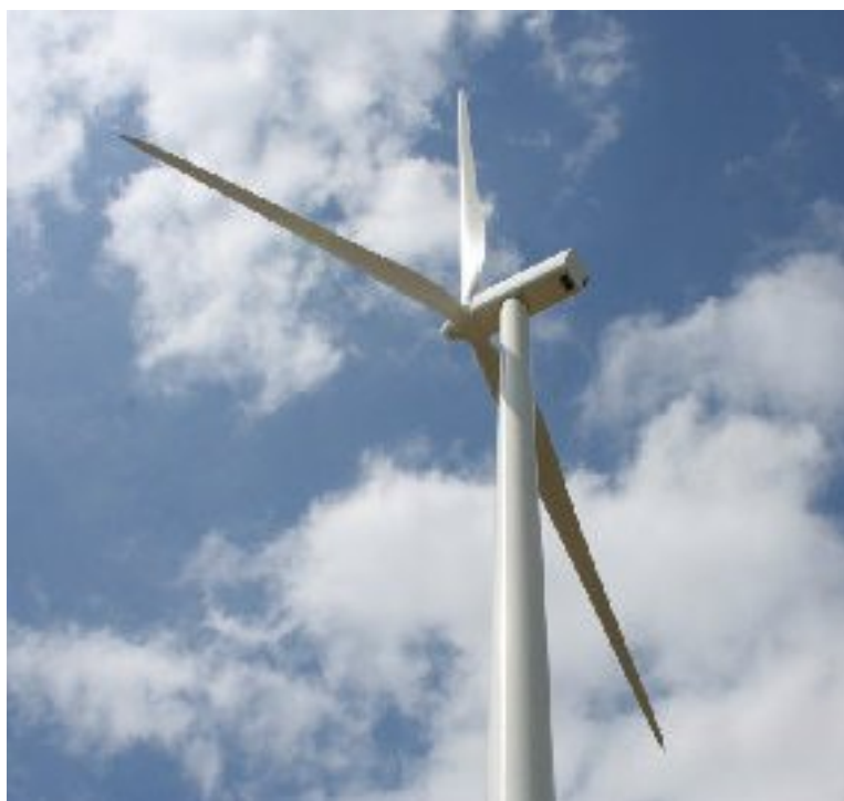
▲ Éolienne du parc en fonctionnement
