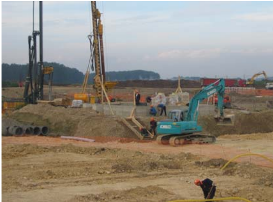
▲ Liebherr LRB 155 (à gauche) en cours de forage et foreuse Keller type TR (à droite) en phase de mise en station
