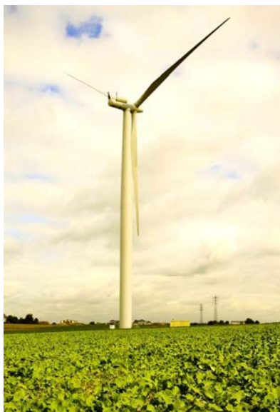
▲ Vue de l'éolienne
