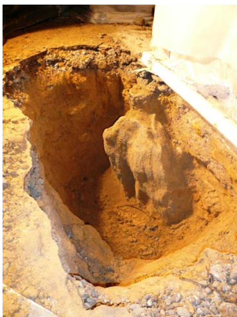
▲ Dégarnissage partiel d'une colonne de CHS
