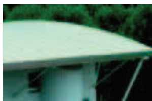
Toiture cintrée en inox. Maison des jeunes et de la culture de Bollwiller, France. Jaegle architecte.
