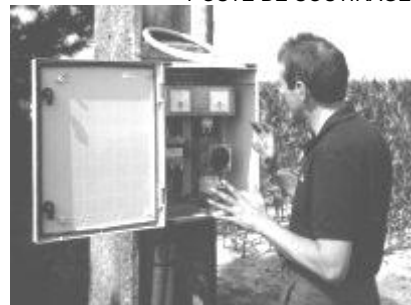
[FIG.6] POSTE DE SOUTIRAGE
