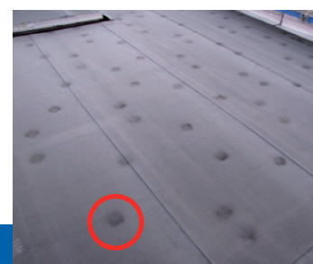
La disparition de givre aux niveaux des vis de fixation confirme la présence de ponts thermiques (points chauds)
