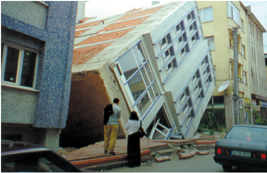
↳ Séisme d'Izmit (Turquie) : perte de portance par liquéfaction du sol lors du séisme du 17 août 1999
