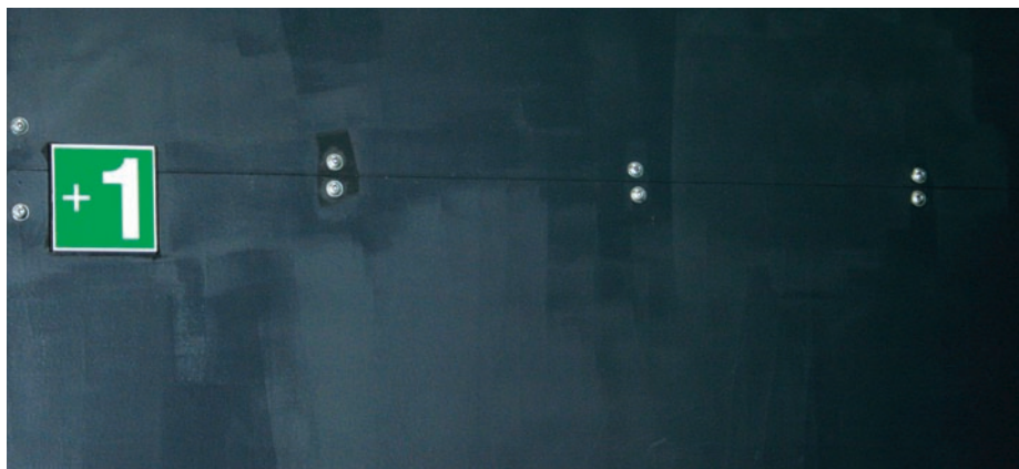
Fig. 3 Une préparation insuffisante peut se traduire par un aspect moins uniforme des travaux de peinture.
