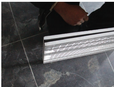
Fig. 1 Ecart de planéité important d'un carreau céramique.
