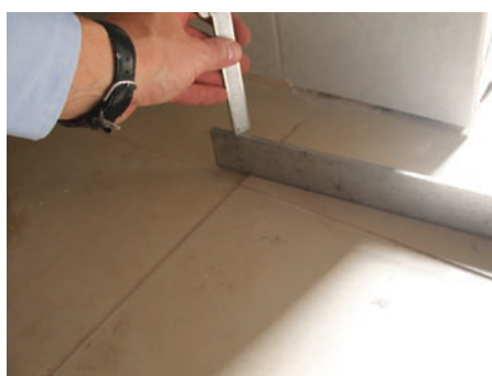
Fig. 5 Mesure du désaffleurement entre deux carreaux adjacents.
